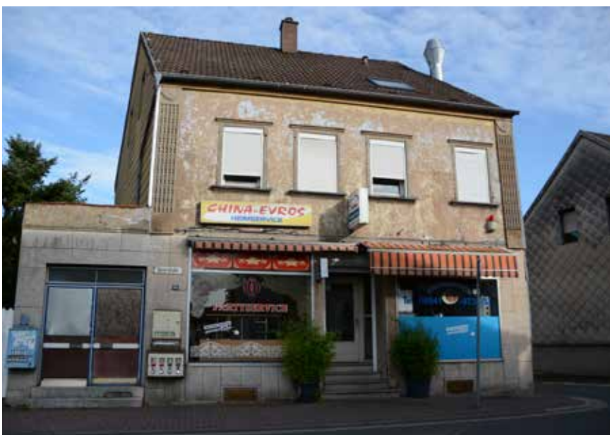
Sanierungsbedürftige Bausubstanz im Bereich der Dürerstraße
