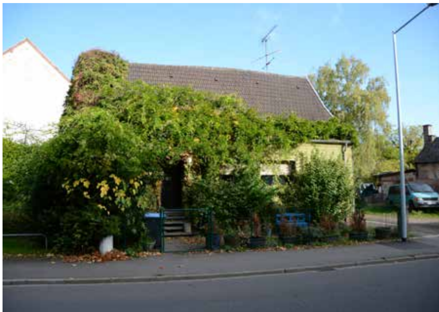
Sanierungsbedürftige Bausubstanz im Bereich der Steinbachstraße
