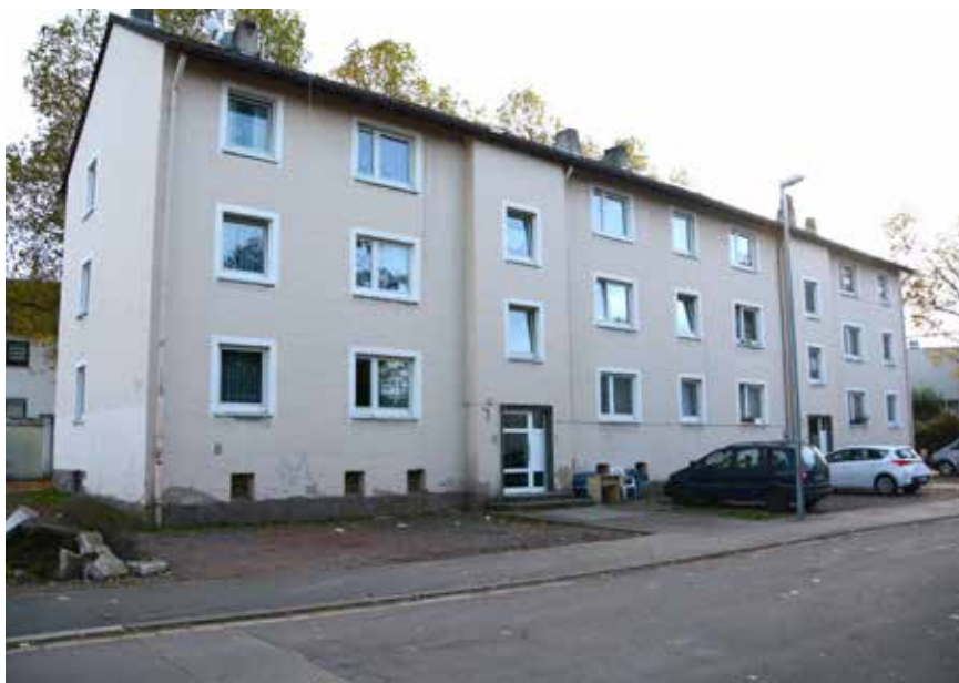
Sanierungsbedürftige Bausubstanz im Bereich der Böcklingstraße
