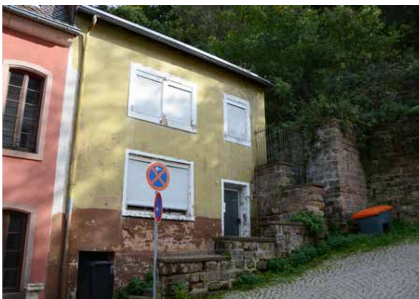
Sanierungsbedürftige Bausubstanz im Bereich der Fruchthallstraße zum Zeitpunkt der Bestandserfassung 10/2019
