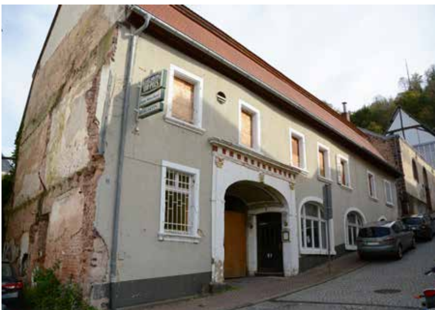
Sanierungsbedürftige Bausubstanz im Bereich der Klosterstraße zum Zeitpunkt der Bestandserfassung 10/2019
