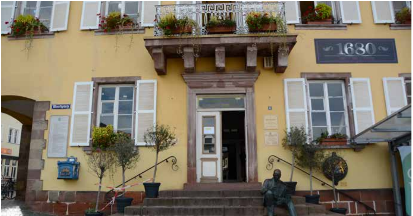
Denkmalgeschütztes „Altes Rathaus“ im Bereich des Marktplatzes mit Modernisierungs- und Instandsetzungsbedarf zum Zeitpunkt der Bestandserfassung 10/2019
