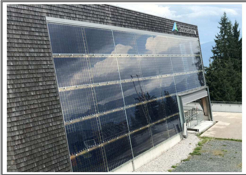
Beispiel Photovoltaik-Fassade, Glocknerbahn Zell am See
