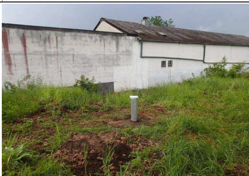
Grundwassermessstelle S0570 mit Stahlschutzrohr und SEBA-Sicherheitsverschlusskappe
