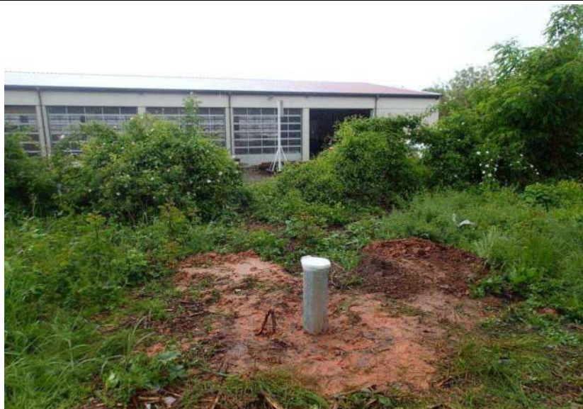
Grundwassermessstelle S0571 mit Stahlschutzrohr und SEBA-Sicherheitsverschlusskappe
