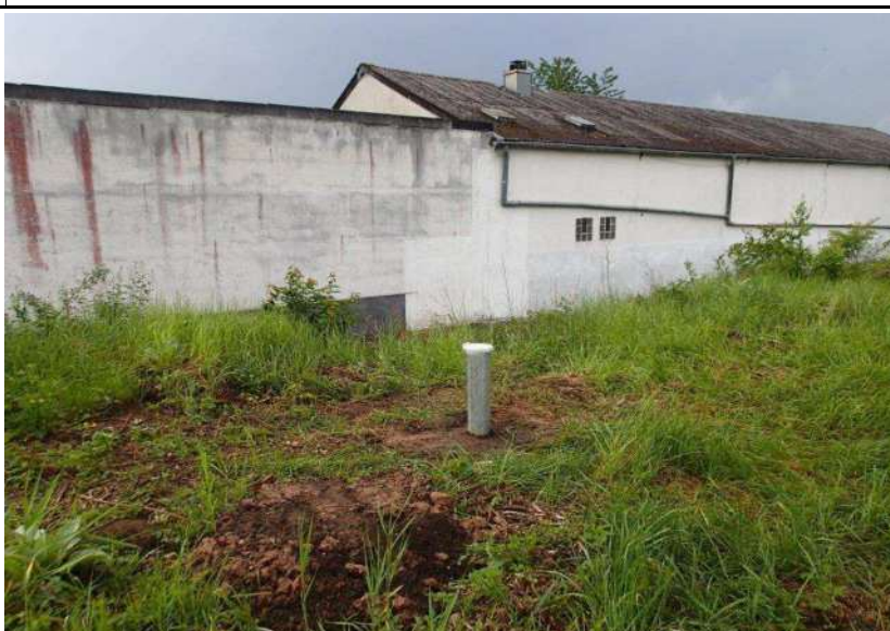
Grundwassermessstelle S0570 mit Stahlschutzrohr und SEBA-Sicherheitsverschlusskappe
