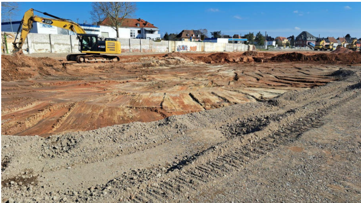
Bild 2: Abtrag von Bodenmaterial und Herstellung der Schottertragschicht (Foto: M. Beckert, Aufnahmedatum: unbekannt).
